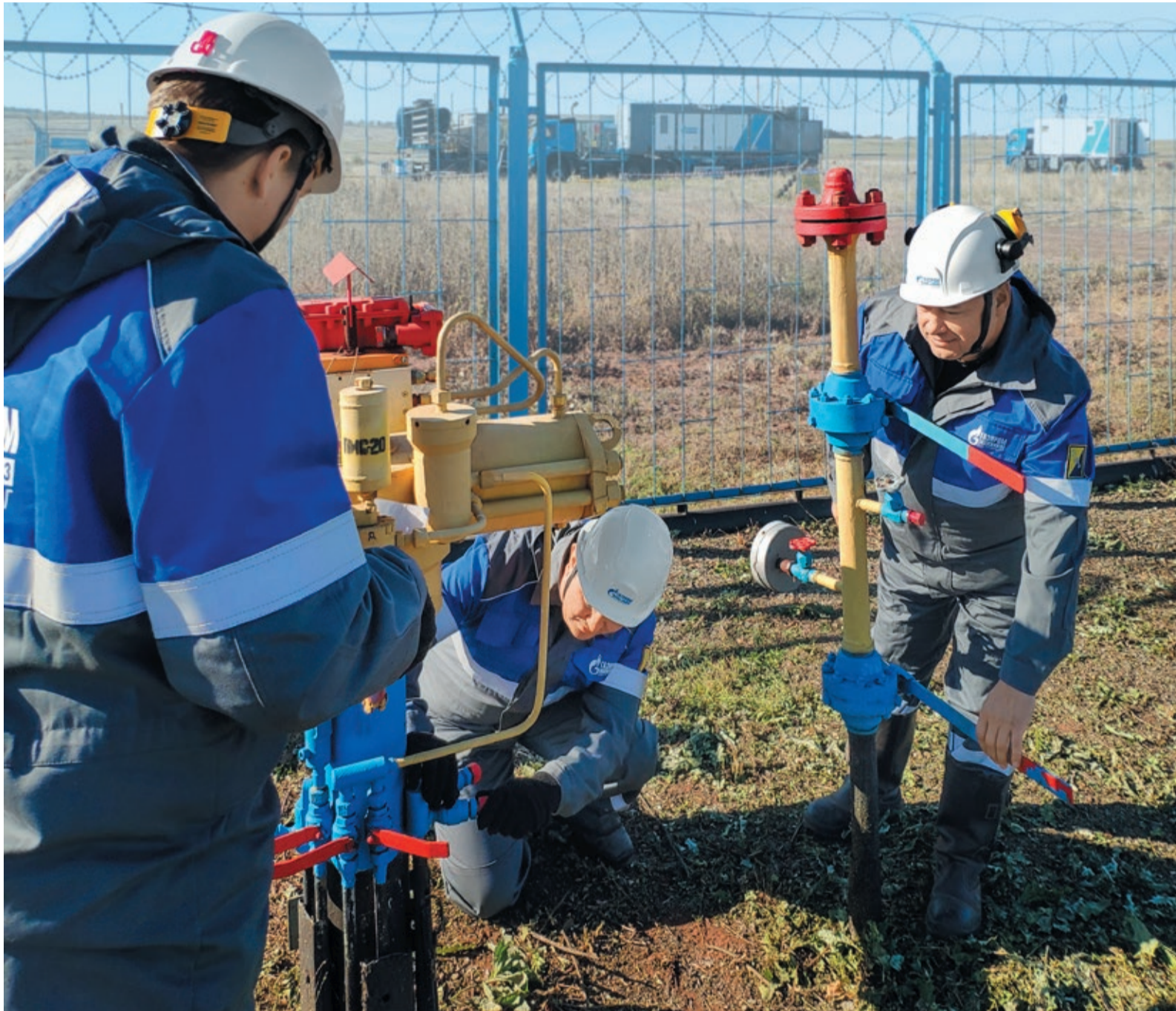
В прошлом году на трассе впервые опробовали мобильную компрессорную станцию. Как отметили оренбургские линтрубы, подключить ее намного проще, чем использовать привычные методы перераспределения потоков и перепуска газа из участка в участок
