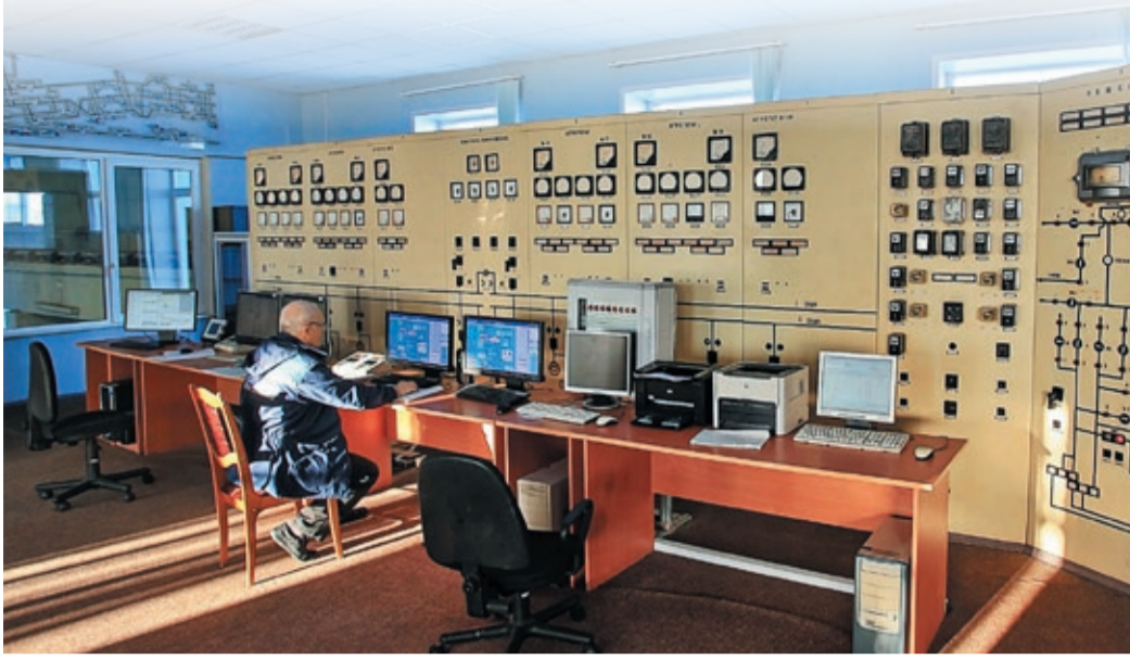
Рациональное распределение нагрузки на электроприводные компрессорные станции позволяет экономить миллионы киловатт-часов электроэнергии
