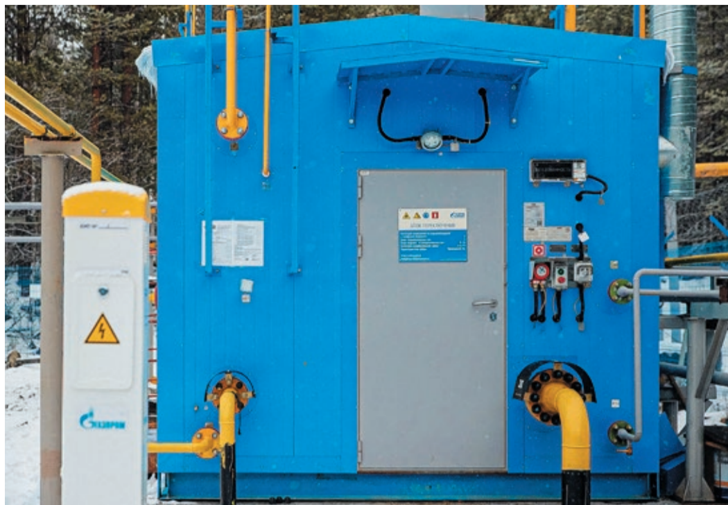
ГРС «Таватуй» обеспечивает газом одноименный поселок и несколько оздоровительных лагерей
