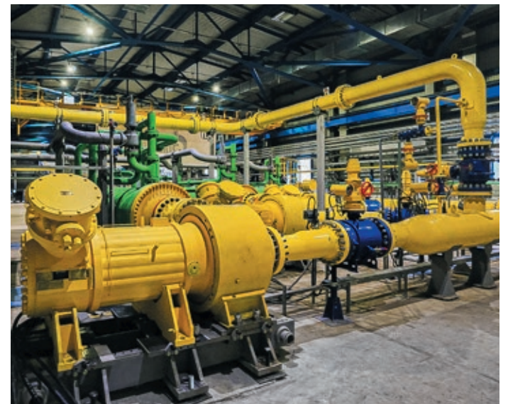
Циркуляцию очищенного газа обеспечивают мощные вентиляторы
