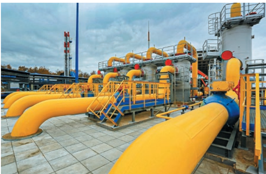
На поверочные установки трубопроводный газ поступает через узел очистки
