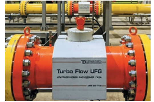
На эталонных нитках стоят сверхточные расходомеры
