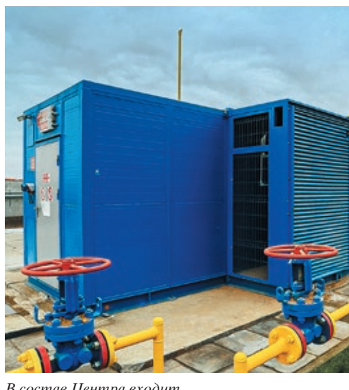
В состав Центра входит модульная компрессорная станция
