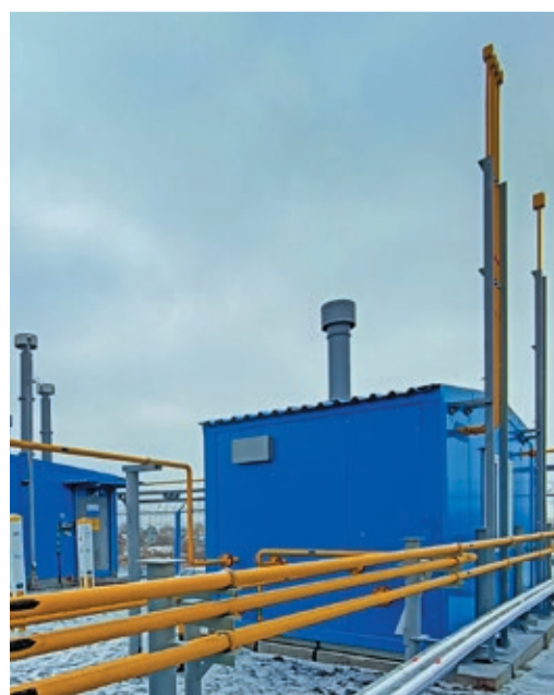
Теперь на ГРС «Садовый» свет включает умная автоматика
