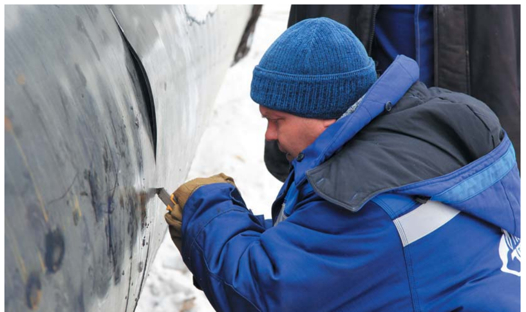
Сергею Колчину приходится не только наносить изоляцию, но и снимать ее с трубы
