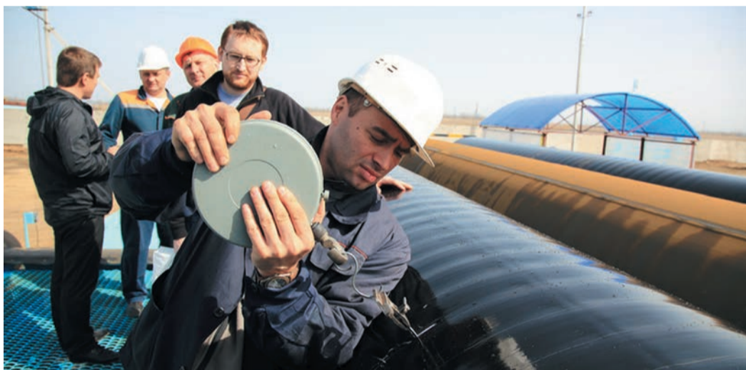
Инженер-контролер КЗИТ Вячеслав Гольдфарб прилагает немало усилий, чтобы проверить прочность новой изоляции
