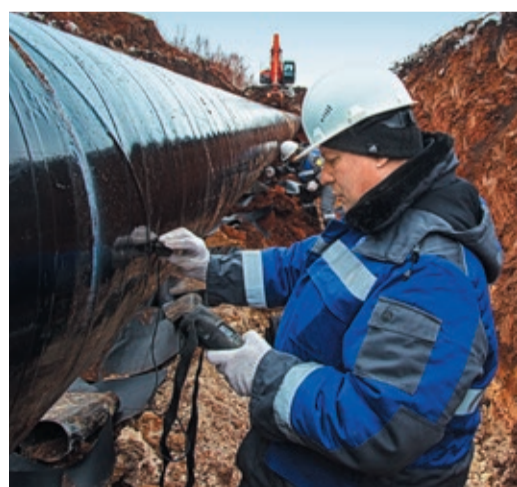
Под блестящей броней изоляции могут скрываться очаги стресс-коррозии
