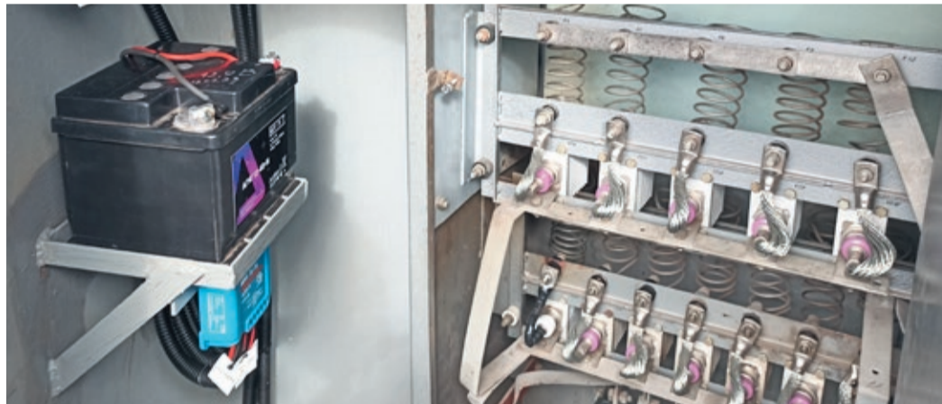
Оборудование для установок дренажной защиты решает несколько задач: сбор данных, связь с операторной и автономное энергообеспечение
