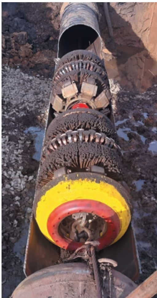
Внутритрубные дефектоскопы являются основным источником информации о состоянии трубы
