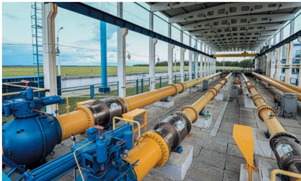
На поверочной установке «УРМЦ-70000» (вторая очередь) можно работать со счетчиками диаметром от 500 до 1000 мм
