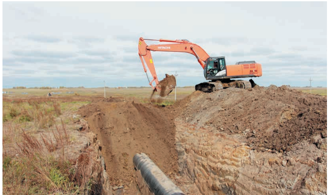
В этом шурфе монтажников встречал еще обычный песчаный грунт, дальше — сплошное болото
