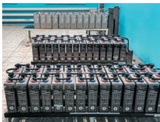
Гелевые аккумуляторы «потянули» автоматику газоперекачивающих агрегатов и главного щита
