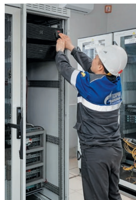
Слесарь Александр Снаткин обслуживает аварийные источники тока
