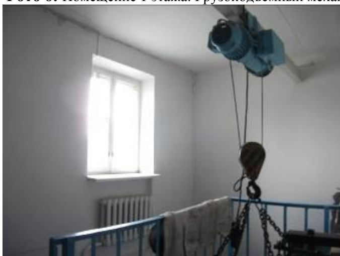
Фото 6: Помещение 1 этажа. Грузоподъемный механизм - кран-балка
